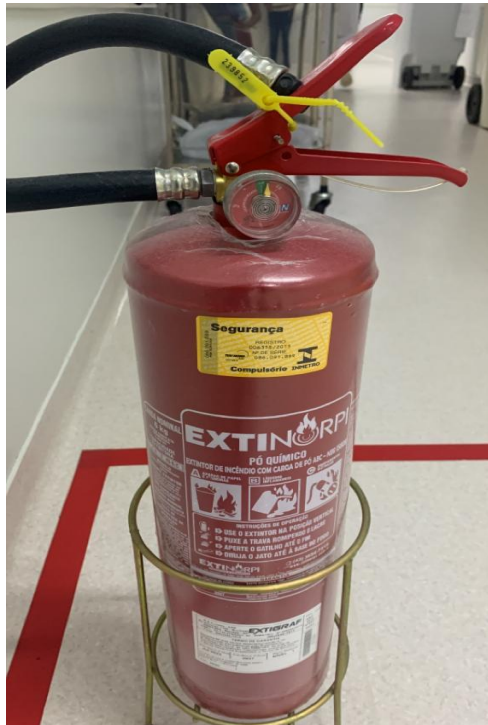
Acompanhamento de abastecimento e validade dos extintores da Unidade
